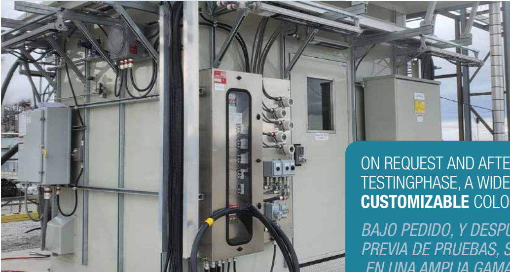
Analyzer shelters made with fiberglass panels inside a petrochemical facility Refugios para analizadores hechos con paneles de fibra de vidrio dentro de una instalación petroquímica
